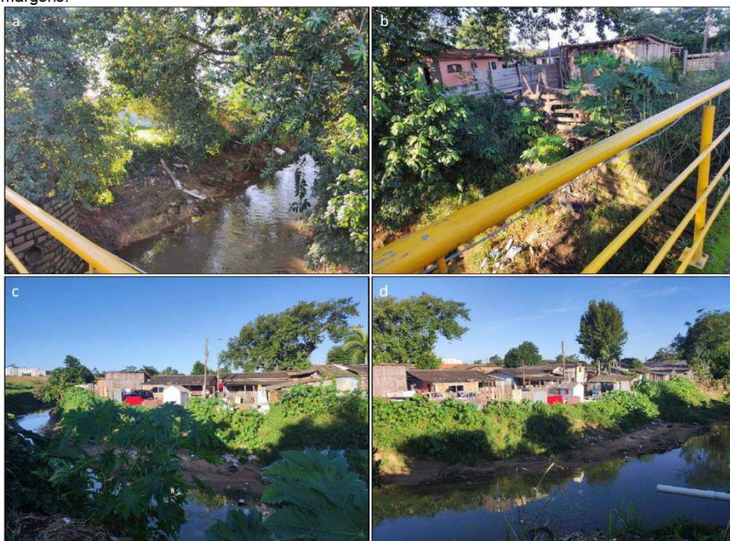
Figura 79 - Local aonde ocorre inundações frequentes com as margens erodidas e muitos resíduos nas margens.
