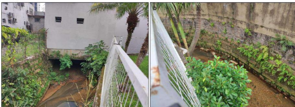
Figura 77 – Curso d'água canalizado com muros de contenção e edificação sobre o curso. Local: Bairro Centro.
